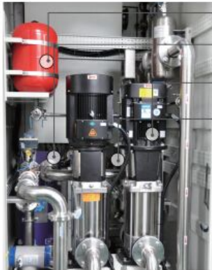
缓冲罐 板式换热器 冷水循环泵 去离子树脂
